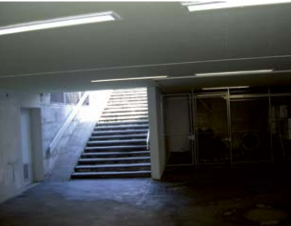
Les passages inférieurs mal éclairés avec des recoins non visibles sont anxiogènes et évités par les piétons.
